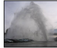
Conduite principale perforée lors d'un forage
