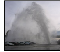
Conduite principale perforée lors d'un forage
